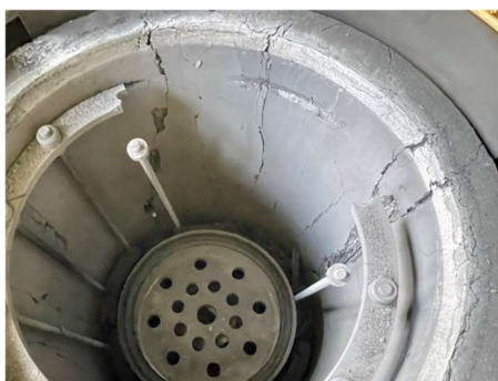
写真 2. 炉内破損状況
